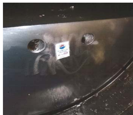
Slika 5 - Kavitaciono oštećenje na dijelu antikavitacione letve kod otvora za montažu i demontažu lopatice
